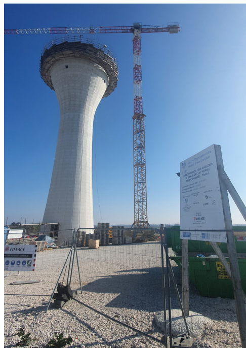
Construction du château d'eau de Courtacon par le S2E77 dans le cadre du projet d'interconnexion du Transpr'eauinois financé à 30 % par le Département.
